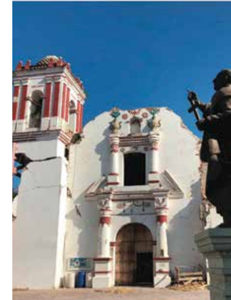
El sismo de septiembre de 2017 causó daños en el templo de San Vicente Ferrer (siglo XVII) dedicado al santo patrono de Juchitán de Zaragoza, Oaxaca (México). La Fundación Alfredo Harp Helú Oaxaca (FAHHO) en alianza con el INAH financió el proyecto ejecutivo de la restauración del templo, la rehabilitación de la casa cural y su pórtico techado, el atrio y el portón de acceso, así como la supervisión de las obras por personal técnico capacitado.
